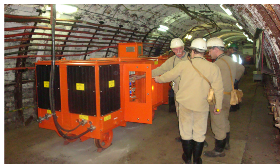
Rys. 9. Widok prostownika w podziemiu KWK
