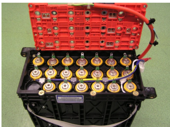
Rys. 3. Bateria akumulatorów samochodu hybrydowego Honda Insight
