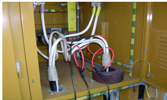
Rys. 6. Pomiar prądu silnika w rozdzielni elastycznymi cewkami Rogowskiego
