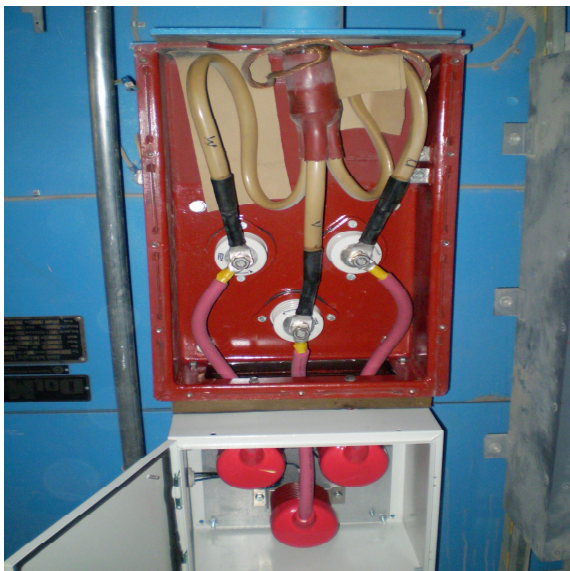
Rys. 11. Zabudowane kondensatory sprzęgające 1000 pF Silnik FH 710 K12 1400 kW 6 kV
