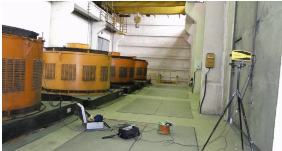
Rys. 11. Bezdotkowy pomiar drgań silników pomp wody chłodzącej (SBJVe-1716r, 2000 kW)
