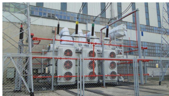
Rys. 19. Widok transformatora dużej mocy (blokowego)
