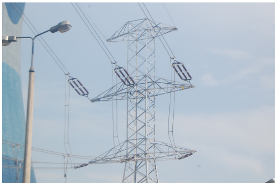
Rys. 27. Widok linii wysokiego napięcia
