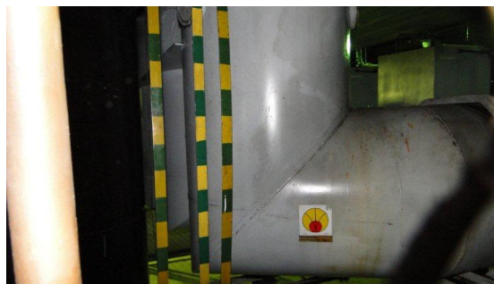
Rys. 25. Widok szyny wyprowadzenia mocy osłoniętej aluminiową rurą
