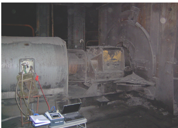
Rys. 11. Widok badanego silnika o mocy 630 kW oraz stanowisko pomiarowe w czasie pomiarów izolacji głównej przy użyciu testu Meggera
