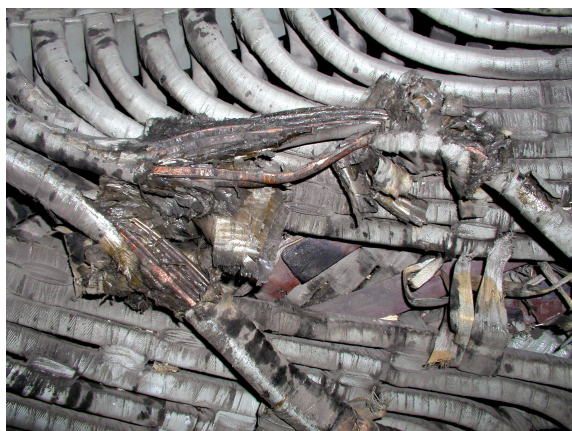
Rys. 3. Typowe deformacje czoł cewek uzwojeń stojanów silników dwubiegunowych: a) - widok rozerwanych wiązań skrajnych cewek, b) - całkowita miejscowa deformacja czoł
