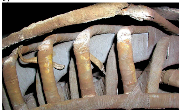
Rys. 7. Wytopienie i deformacja połączeń zasilających – a) oraz wytarcia izolacji na połączeniach międzycewkowych - b)
