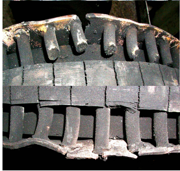
Rys. 10. Pęknięcia pierścieni zwierających uzwojenia klatkowe wirników
