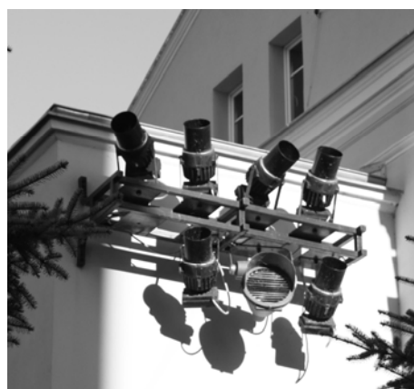
Rys. 12. Sposoby montażu opraw oświetleniowych na elewacji – na wspornikach lub na wysięgnikach (zdj. J. Ratajczak)
