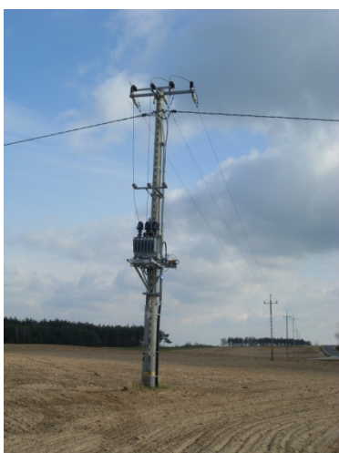
Rys. 19. Widok nowej stacji typu STS na żerdzi wirowej typu E
