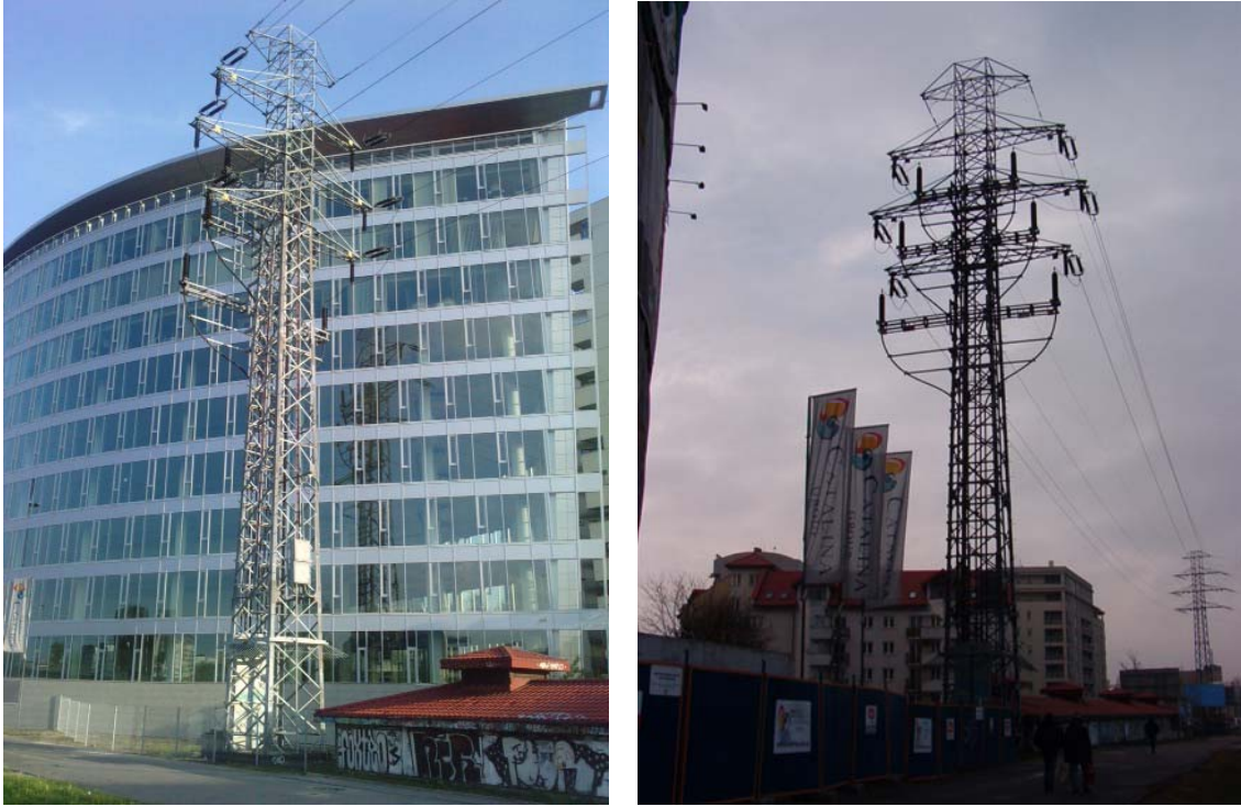
Rys. 2. Słup linii 110 kV z przejściem na podziemną linię kablową zlokalizowany w sąsiedztwie biurowca CATALINA
