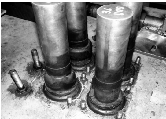
Rys. 1. Widok przegrzanych przepustów niskiego napięcia transformatora pieco-kadzi [2]
