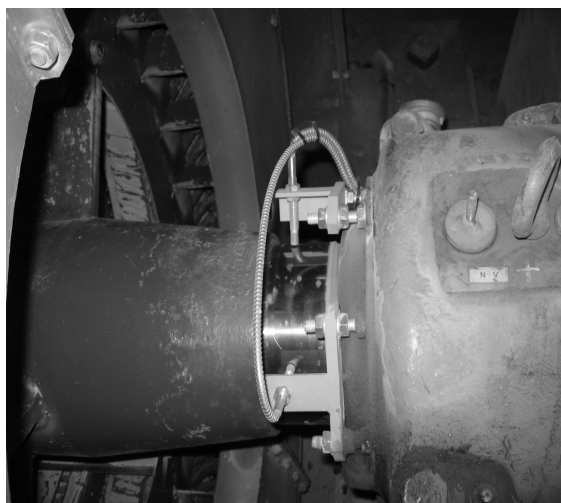
Rys. 6. System pomiaru drgań względnych silnika SYUe-148r/01 1000kW 6 kV
