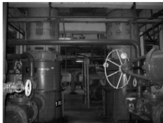
Rys. 16. Widok ogólny zespołów pompowych kondensatu
