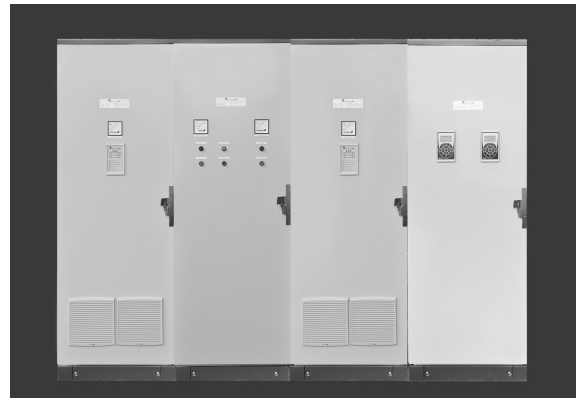
Rys. 1. Statyczny układ wzbudzenia typu ETW55SC2 do generatora 55 MW
