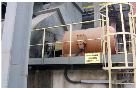
Rys. 1. Napęd wentylatora spalin w jednej z krajowych elektrociepłowni, silnik indukcyjny z wirnikiem klatkowym WN o mocy 800 kW
