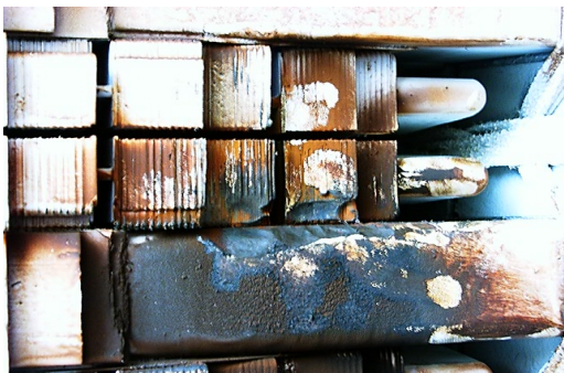
Rys. 1. Zwarcie blach zębów skrajnych pakietów rdzenia („pożar żelaza”) oraz uszkodzenie izolacji pręta uzwojenia w stojanie dużego turbogeneratora
