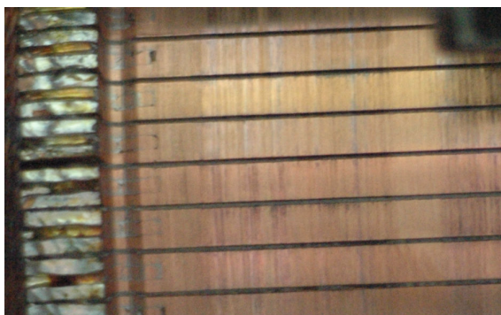
Rys. 3. Widok działek komutatora maszyny prądu stałego przy słabym iskrzeniu szczotek
