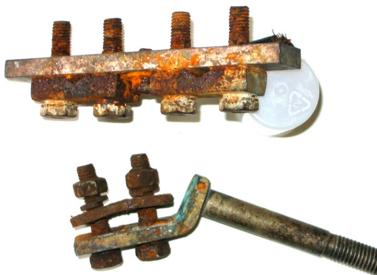
Rys. 11.3. Przykład niedopuszczalnego połączenia stykowego metali: powłoki srebrnej z powłoką kadmową. Wygląd elementu po 1 roku eksploatacji w warunkach kopalnianych [311]
