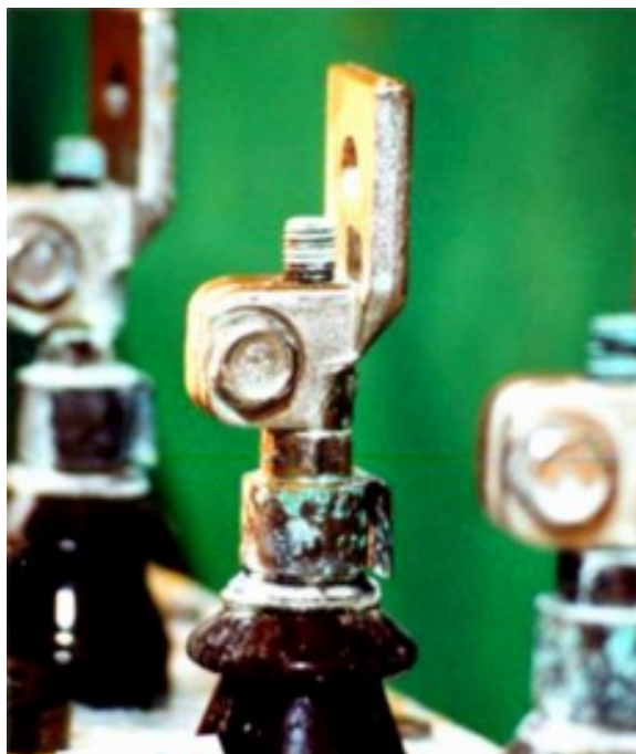
Rys. 11. 1. Przykład korozji galwanicznej elementów konstrukcyjnych transformatora po 1500 h narażania w komorze solnej [315]
