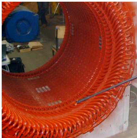
Rys. 12. Pomiar wnz off-line na stojanie prototypową sondą wykorzystującą antenę przenośną
