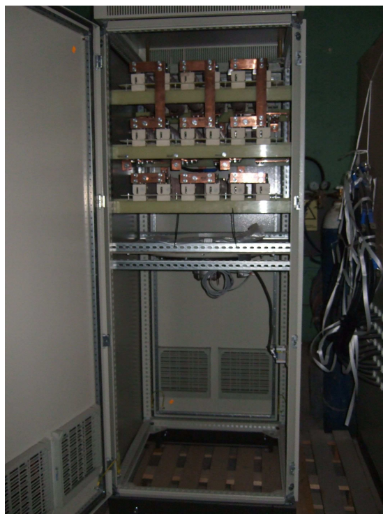
Rys. 5. Widok części oporowej rozrusznika silnika 1000 kW, 6 kV
