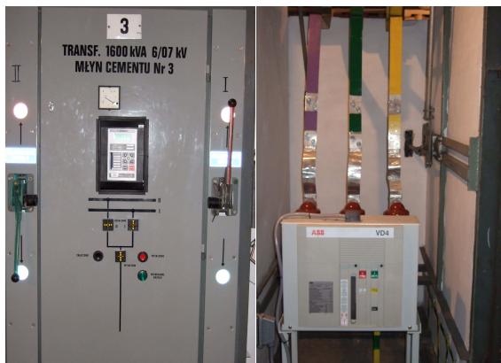
Rys. 2. Widok pola silnikowego 6 kV po modernizacji
