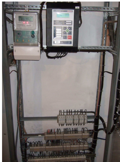
Rys. 4. Przedział zabezpieczeń pola 6 kV po modernizacji
