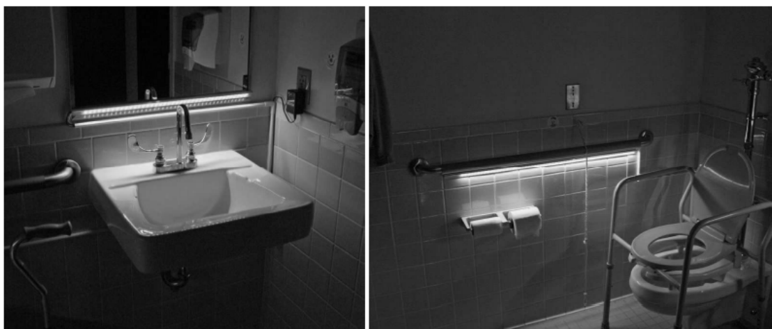
Rys. 7. Przykład oświetlenia orientacyjnego LED w łazience [4]
