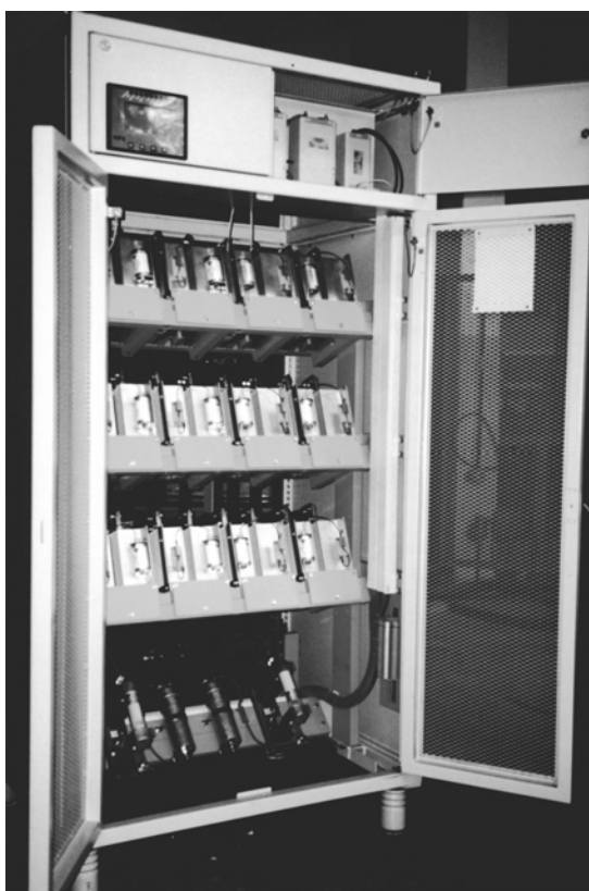
Rys. 13. Prostownik diodowy PD-1,2/0,66 (1200 A, 660 V) dla podstacji tramwajowych i trolejbusowych. Opracowanie i badania Instytut Elektrotechniki. Wykonanie Przedsiębiorstwo Kolejowych Robót Elektryfikacyjnych
