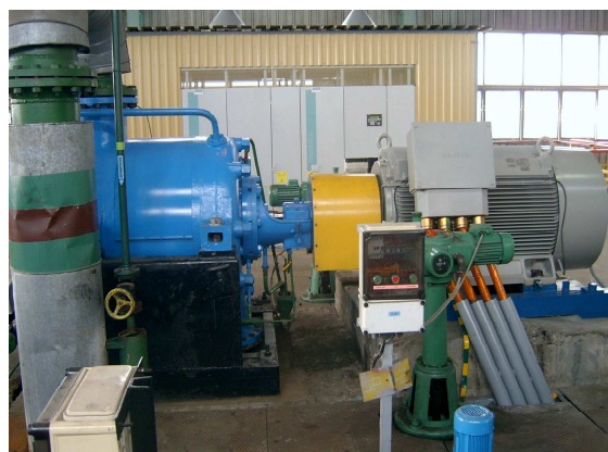
Fot. 3. Widok instalacji
