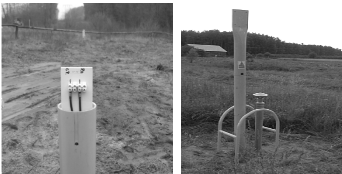
Rys. 7. Punkt kontrolno-pomiarowy i elektroda anodowa
