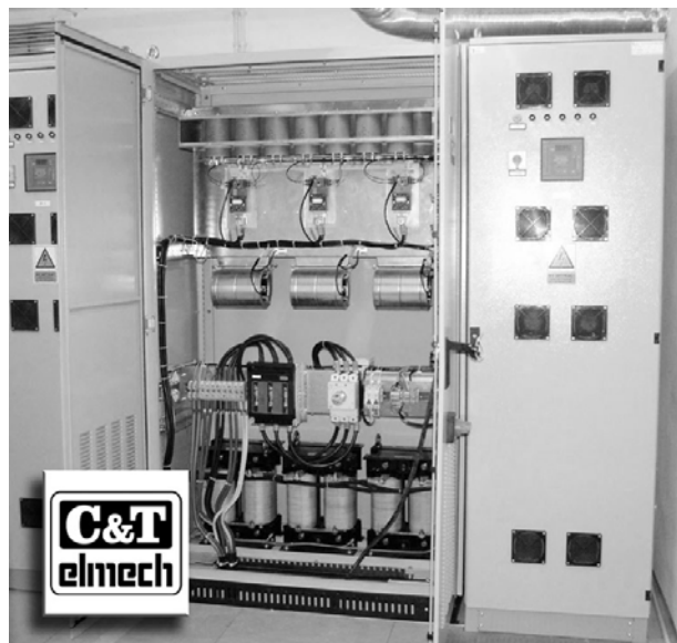
Rys. 8. Filtr aktywny XINUS firmy C&T Elmech o mocy 150 kVA zainstalowany w rafinerii LOTOS S.A.
