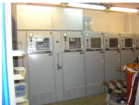
Rys. 5. Rozdzielnia z polem rewersyjnym
