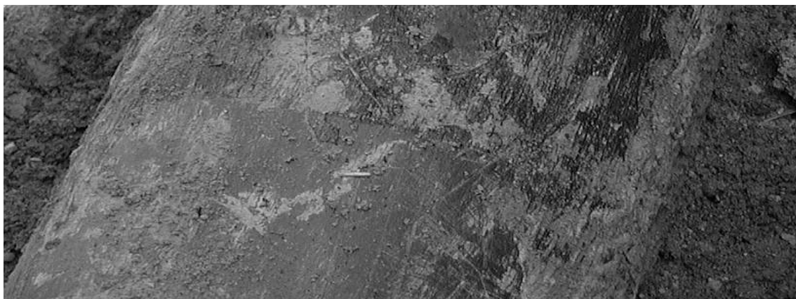
Rys. 3. Defekt zlokalizowany metodą DCVG
