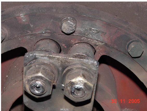
Rys. 6. Wygląd zacisków przyłączeniowych z widocznymi śladami działania łuku przy wyladowaniach do osłony
