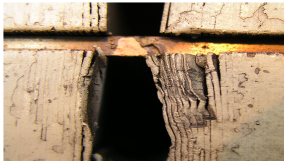
Fot.4 Uszkodzone żelazo czynne
