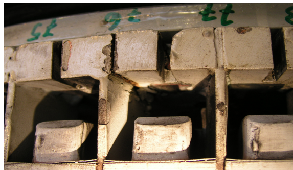
Fot.2 Pęknięte mocowanie pręta klatki z pierścieniem
