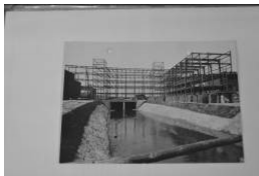
Ryc. 35. Konstrukcja stalowa Szkoły Zawodowej (dziś Klinika Stomatologii). Widok na wpływającą pod konstrukcję rzekę Bytomkę. Źródło: Dariusz. Walerjański.
