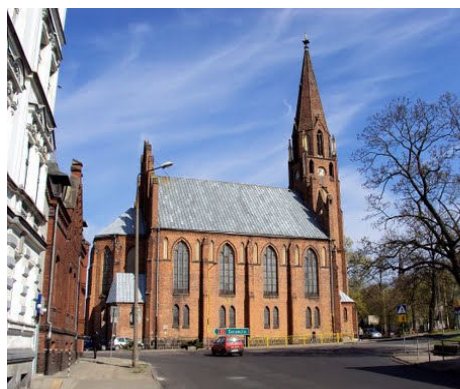
Ryc. 3. Elewacja południowa – zagrożenie przez bliskość dawnej drogi krajowej nr 10. Źródło: fot. H. Rutyna, XII.2008
