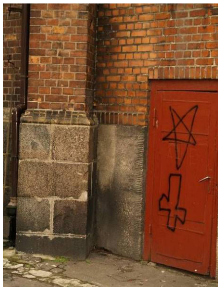
Ryc. 20. Styk cokołu granitowego (nawa kościoła) i cokołu betonowego (kaplica przy prezbiterium). Źródło: fot. H. Rutyna, XII.2008 Fig. 20 Contact granite plinth (the nave of the church) and the concrete plinth (the chapel at the presbytery). Source: photo H. Rutyna, XII. 2008
