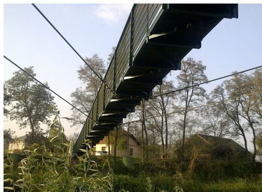
Ryc.12. Usztywnienia kładki ukryte pod poziomem pomostu oraz podwójne odciaży. Źródło: fot. autora Fig.12. Bridge stiffening hidden under the deck. Source: photo by author
