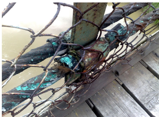
Ryc.8. Korozja lin i dewiatorów. Źródło: fot. autora. Fig.8. Corrosion of ropes and posts. Source: photo by author
