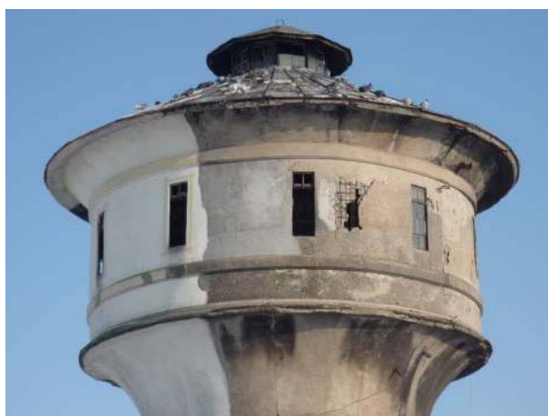
Ryc. 8. Widoczne zniszczenia głowicy wieży w Żninie. Źródło: il. autora
