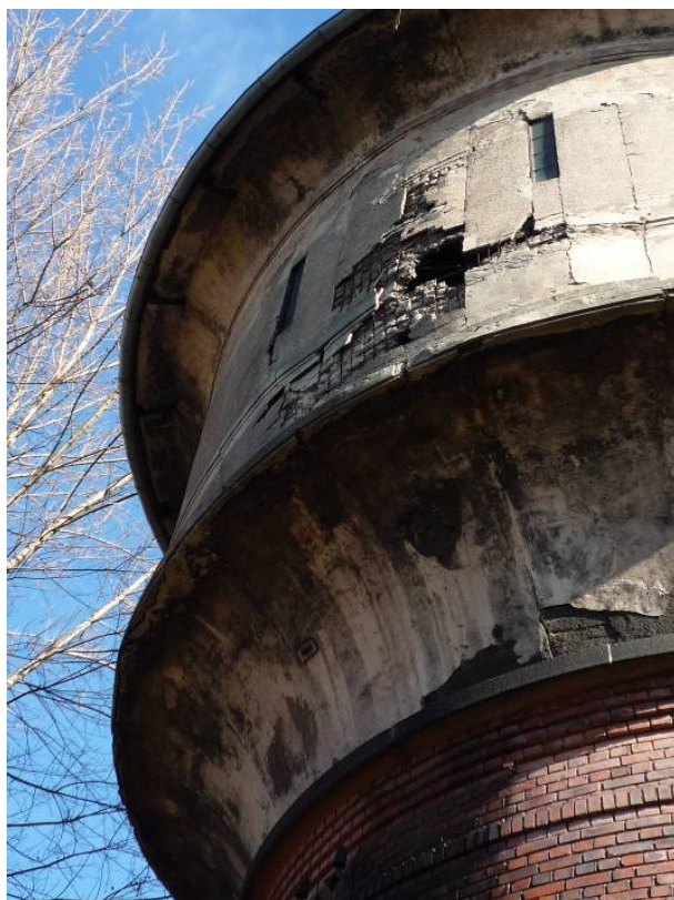
Ryc. 9. Uszkodzenie głowicy wieży ciśnieniowej w Inowrocławiu. Źródło: il. autora
