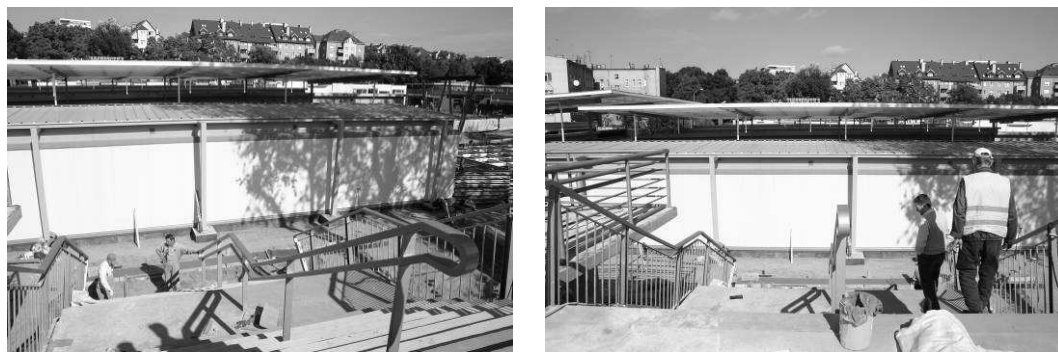
Ryc. 23. Problemy urbanistyczne projektu widoczne w trakcie realizacji kładki. Źródło: autor
