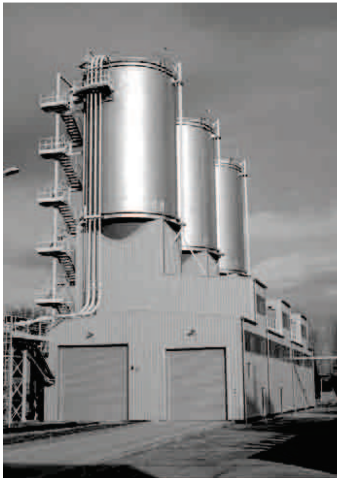
Fot. 3. Instalacja suchego odbioru popiołu
