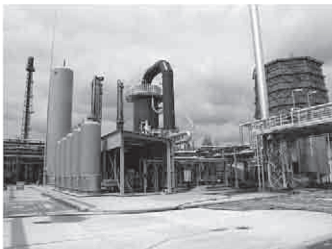
Fot. 3. Węzeł PSA wytwórni wodoru
