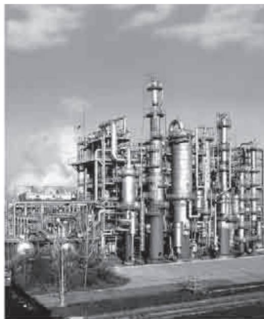
Fot. 1. Instalacja utleniania cykloheksanu w Zakładach Azotowych w Tarnowie
