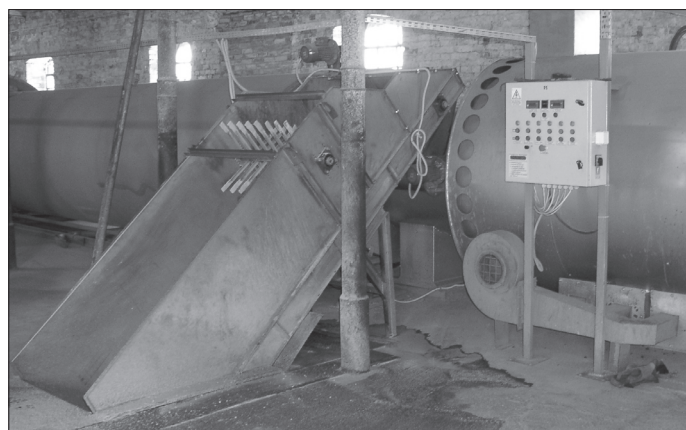
Rys. 3. Suszarka bębnowa zainstalowana na terenie gorzelnicy
