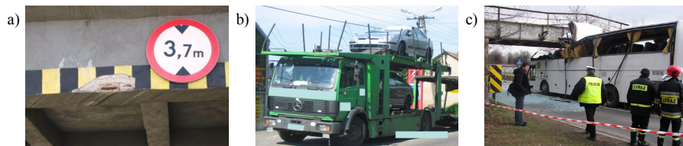
Rys. 3. Przykłady uszkodzeń obiektów i pojazdów w wyniku wjechania pojazdu wyższego niż wysokość skrajni. Belka wiaduktu z odsłoniętym zbrojeniem a); wysokość pojazdu zależy od przewożonego ładunku b); poziom oczu kierowcy znajduje się poniżej połowy wysokości pojazdu c)
