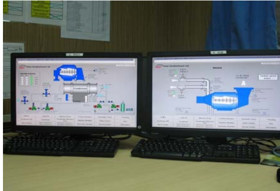
Rys. 3. Widok ekranów systemu monitorowania zespołu prądotwórczego
