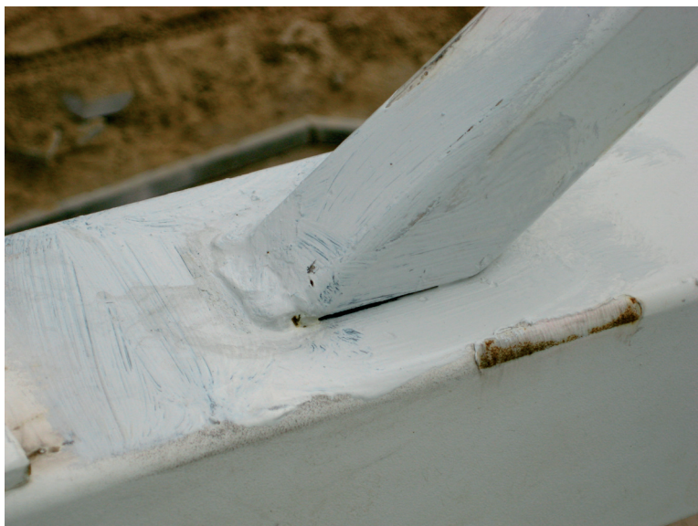
Fot. 8. Niepełna spoina łącząca krzyżulec z pasem kratownicy. Photo 8. The incorrect weld between cross brace and a beam's flange.
