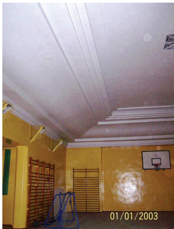
Rys. 4. Widok sufitu sali gimnastycznej po katastrofie Fig. 4. View of the gymnasium's ceiling after the catastrophe
