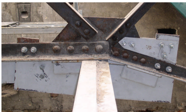
Rys. 6. Widok wzmocnionego węzła pasa dolnego wiązara trapezoidalnego Fig. 6. View of the strengthened node at the bottom chord in the trapezoidal truss
