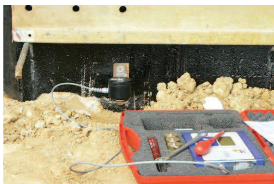
Rys 11 Czujnik na fundamencie przyczółka Fig. 11. Sensors on the bridge abutment
