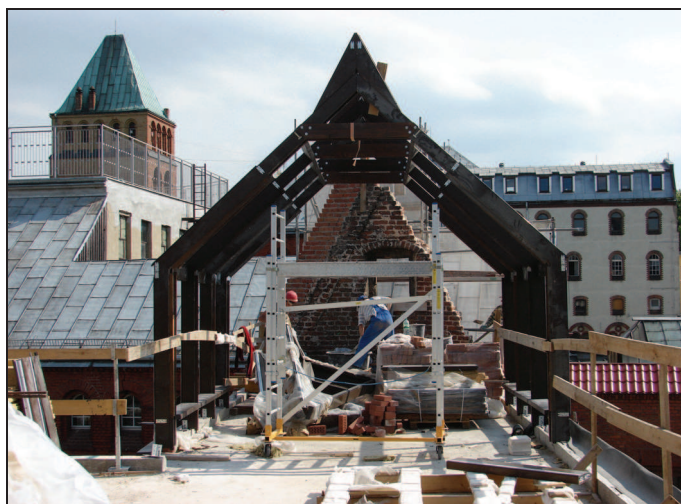
Rys. 2. Charakter odkształceń dachu Fig. 2. The roof deformation pattern
