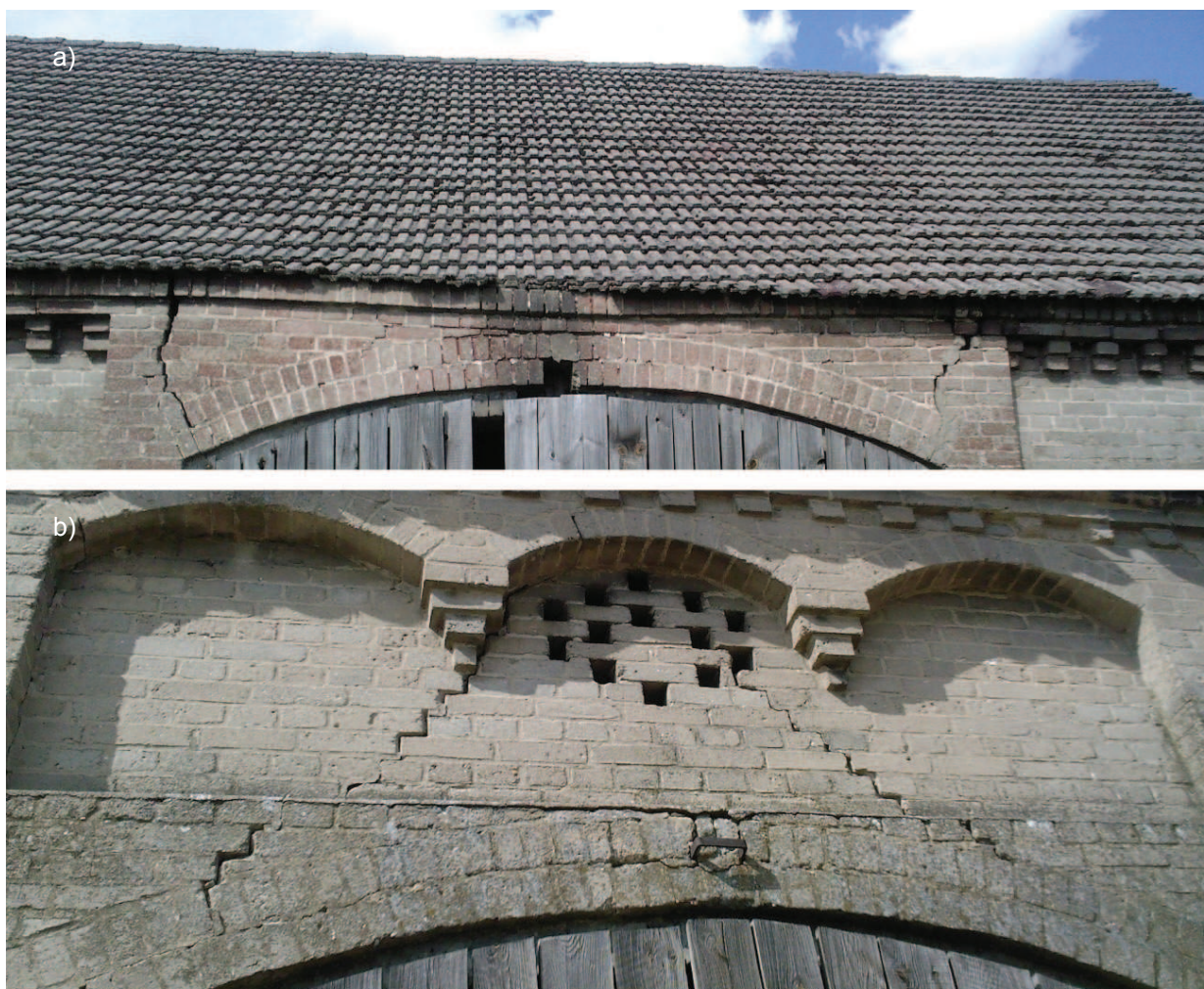
Rys. 4. Zniszczenie ceglanego nadproża łukowego z uwagi na: a – powstanie ustroju trójprzegubowego, b – powstanie wtórnego łuku Fig. 4. Damage of brick, arched lintels' construction because of: a – triple-hinged framework, b – derivative arch
