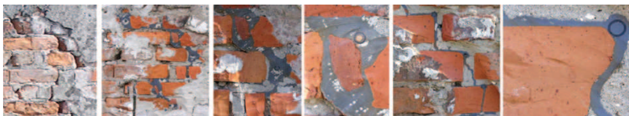
Rys. 3. Polimerowe złącze podatne wykonane w pękniętym budynku murowanym z cegieł Fig. 3. Polymer flexible joint constructed in a cracked masonry building
