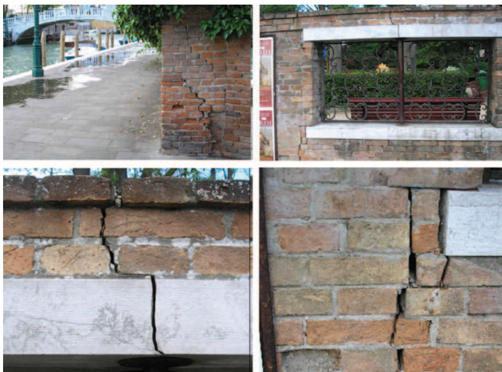
Rys. 4. Pęknięty mur w Wenecji, odpowiedni do naprawy polimerowym złączem podatnym Fig. 4. Cracked masonry wall in Venice, adequate for injection using of polymer flexible joint
