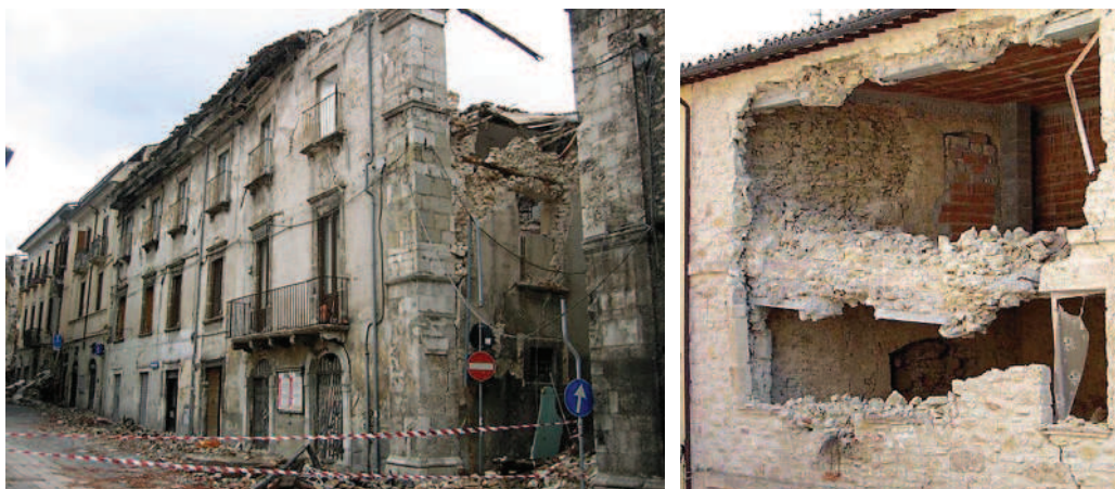
Fig. 1. Example of out-of-plane collapse (left); out-of-plane collapse of a wall with r.c. tie beams (right) Rys. 1. Przykład zawalenia się pozapłaszczyznowego (z lewej strony); pozapłaszczyznowe zawalenie się ściany ze ściągami z belki żelbetowej (z prawej strony)
