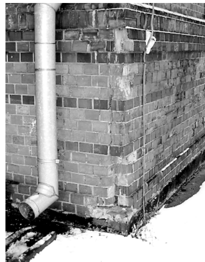
Ryc. 8, 9. Stan techniczny ceglanych elewacji pawilonu. Uszkodzenia dolnej części murów wynikające z dużego zawilgocenia, korozji mrozowej i obecności soli rozpuszczalnych [2] Fig. 8, 9. Technical condition of brick elevations of the pavilion. Damage of the bottom section of the wall resulting from excessive moisture, frost corrosion and the presence of soluble salts [2]
