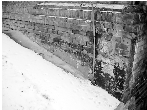
Ryc. 17. Strefa przyziemia budynku. Zły stan techniczny izolacji przeciwwodnych [2]
