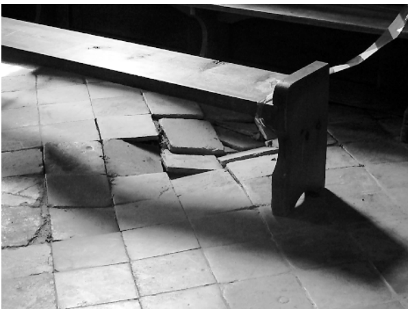
Ryc. 4. Binarowa. Przykładowe deformacje posadzki kościoła. Fot. Jan Janczykowski, czerwiec 2010 Fig. 4. Binarowa. Sample deformations of the church floor. Photo Jan Janczykowski, June 2010
