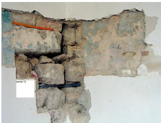
Ryc. 2. Widok na odsłonięte spod tynku lico ściany zachodniej przystawionej do muru magistralnego budowli romańskiej z wyraźną dylatacją. Fot. K. Stala
